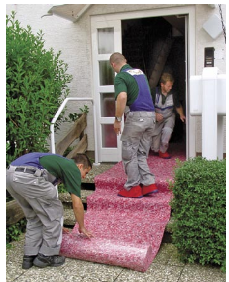
Der rote Teppich: Wenn die Laufwege bei größeren Arbeiten abgedeckt werden hinterlässt dies bei den Kunden einen guten Eindruck und verhindert Verunreinigungen
